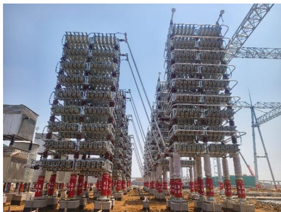
陇东-山东±800kV 特高压直流 输电工程东平换流站
