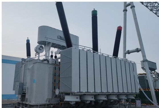
中核汇能甘肃金塔汇升 330kV 主变项目
