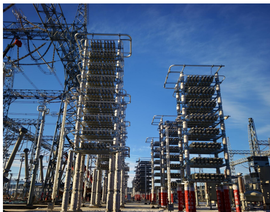
哈密-重庆 800kV 特高压直流 输电工程巴里坤换流站
