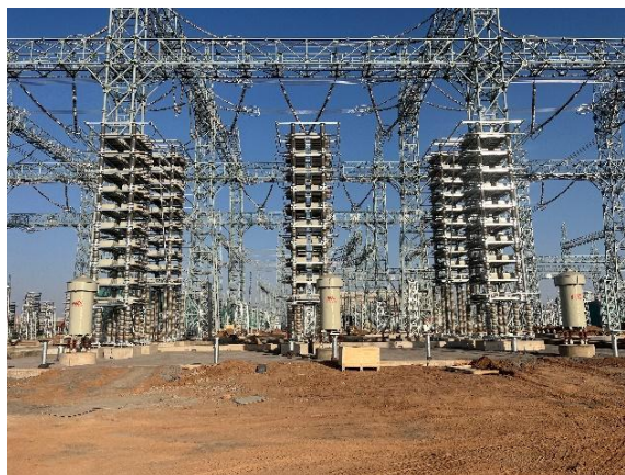
宁夏-湖南±800kV 特高压直流 输电工程中宁换流站
