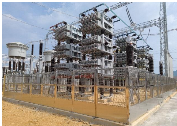
金上-湖北±800kV 特高压直流 输电工程黄石换流站
